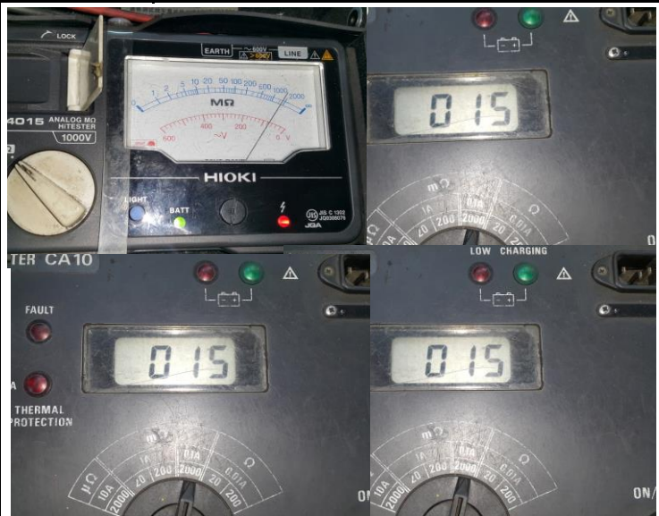
출고검사 절연저항 & 각 상별 권선저항
