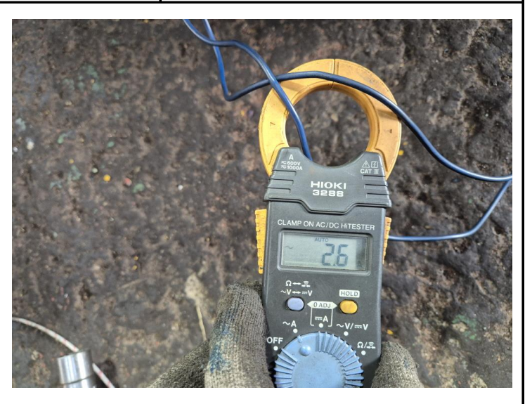
출고검사 제습 HEATER 220V CURRENT
