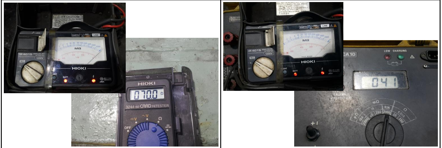
입고검사 A 제습 HEATER 절연저항 & 권선저항 입고검사 B 절연저항 & 각 상별 권선저항 동일
