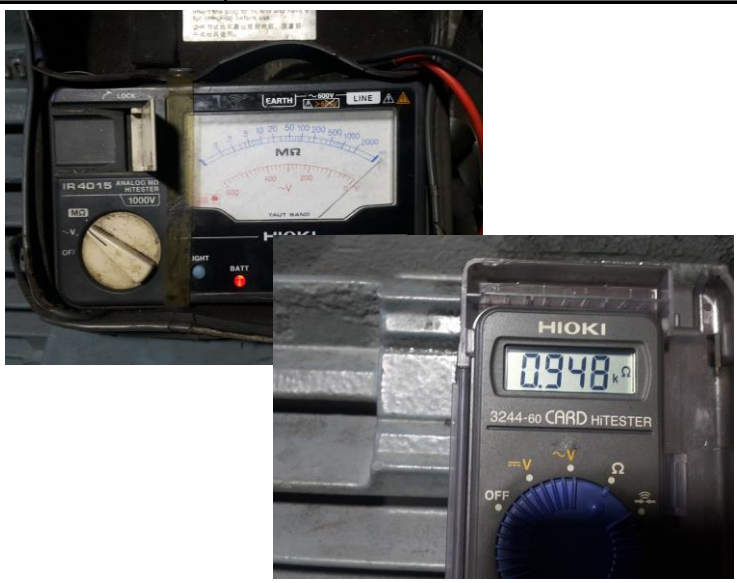
제습 HEATER 절연저항 & 권선저항
