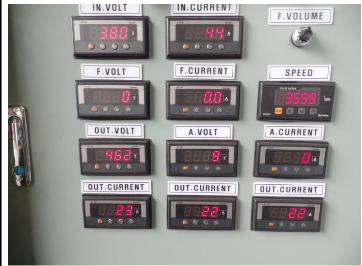
출고검사 시운전 TEST 운전 MONITORING
